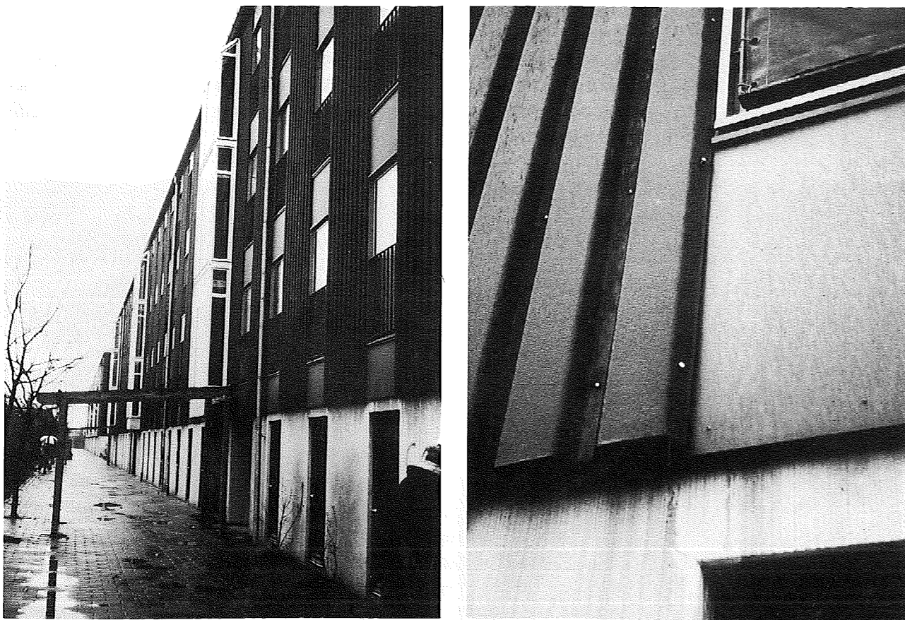
Figur 5 og 6. Tilstandsregistrering: Stålpladebeklædning på træskelet, og indbygning af snedkerparti. Stålpladerne op til 10 m lange, hvilket kan give en temperaturbetiget længdeændring på godt 1 cm.
